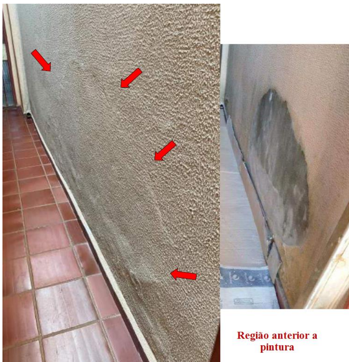
Figura 3 – Umidade ascendente no muro divisório.
