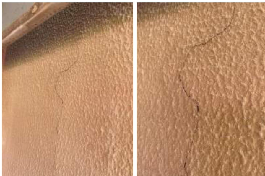
Figura 1 – Fissura na junção do muro em alvenaria com o pilar de concreto.
