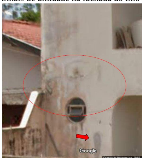
Figura 2 – Sinais de umidade na fachada do imóvel em 2015.
